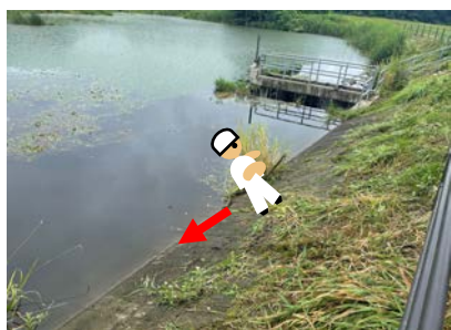
(ため池堤体の急傾斜)
